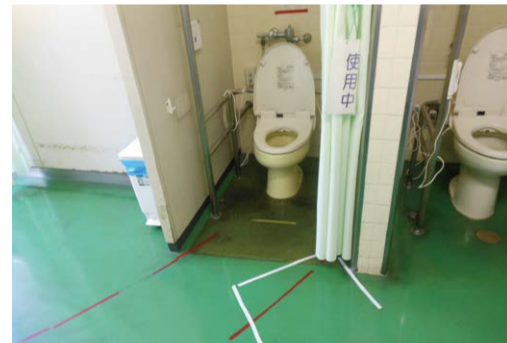
「車イスに対応できていない狭いトイレ」
